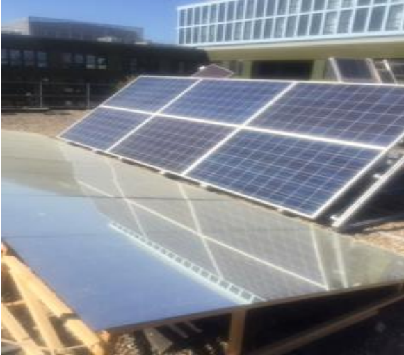
Fig.1-Plateforme PV équipée de réflecteurs plans
