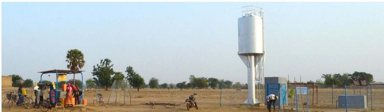
Figure 2 - PVWPS installé dans le village de Gogma, Burkina Faso
